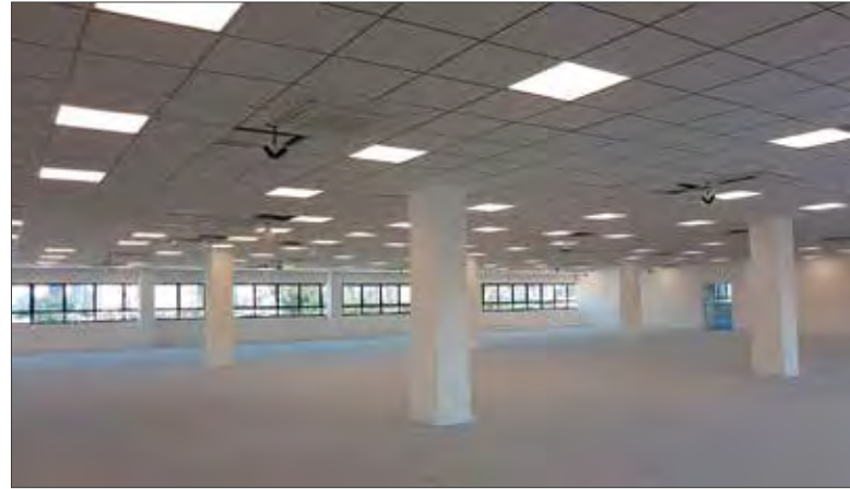
Effiziente Steuerung von 1600 Beleuchtungsvorschaltgeräten wird bereitgestellt.
