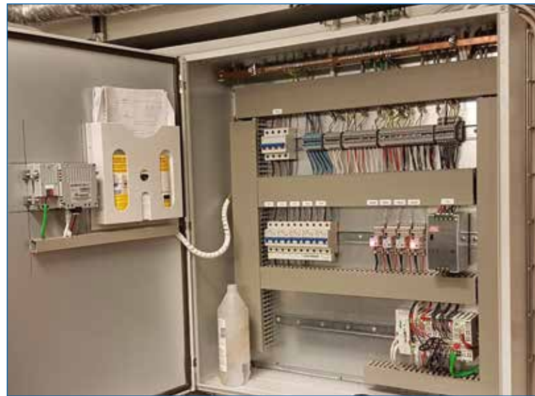
Eine Wago SPS mit KNX Modul regelt die Warmwasser Außenheizung.
