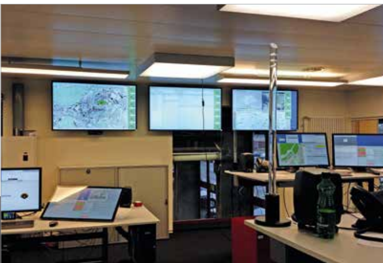
Perfektes Licht für das „Herz“ der Schaltzentrale
