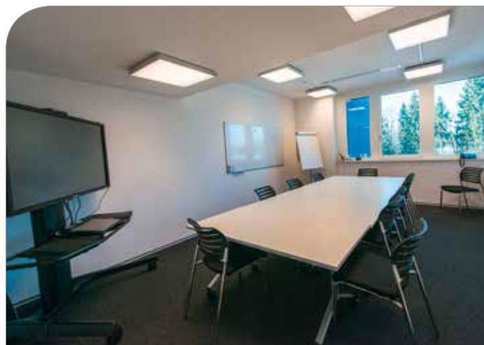
Die KNX Busgeräte steuern sämtliche Beleuchtungen auf den 12.400 m 2 – die Vorteile der DALI-Lichtsteuerung werden mit Dimmen und Leuchtmittelüberwachung genutzt
