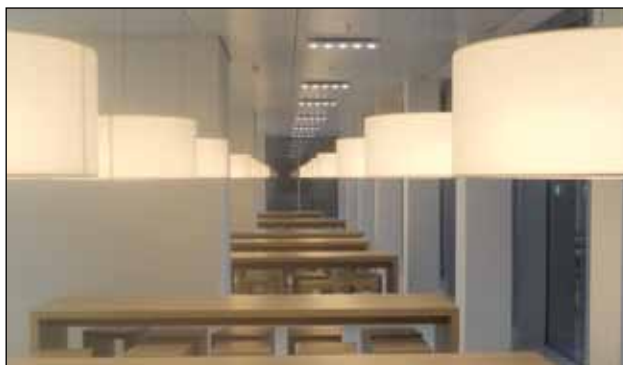
Da ist Energieeffizienz drin: Rund 12.000 Leuchten – darunter 7.000 mit LED – werden per KNX gesteuert und geregelt.
