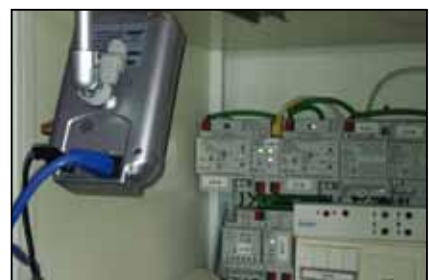
Ansicht einer KNX Trainingskabine
