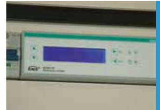
Een ekinex® KNX-mengafsluiter stuurt de servomotor van een mengklep aan die de juiste temperatuur geeft aan de ventilatorconvectoren.
