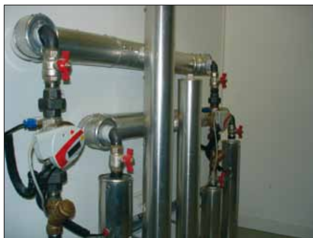
Figur 1. Värmemätning med M-Bus gränssnitt och M-buss-KNX port
