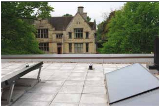
Slika 4. Obnovljivi izvori: solarni paneli za potrošnu toplu vodu.
