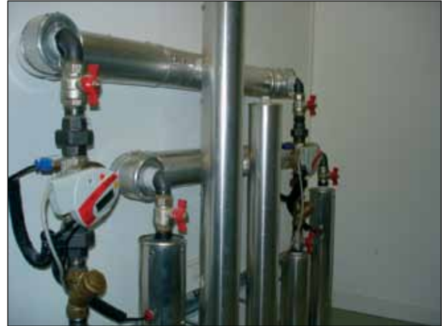
Wärmezähler mit M-Bus-Schnittstelle und M-Bus-KNX-Gateway
